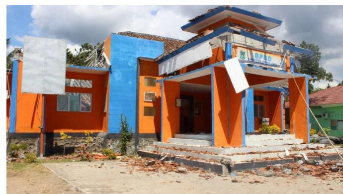
Gambar 56. Dampak gempa pada rumah warga dan bangunan perkantoran
