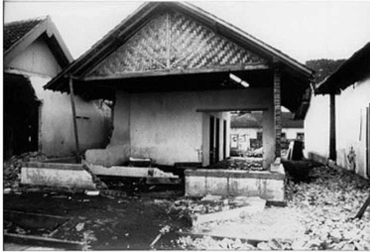
Gambar 38. Rumah batu bata terletak 250 m dari garis pantai yang mengalami kerusakan akibat diterjang gelombang tsunami
