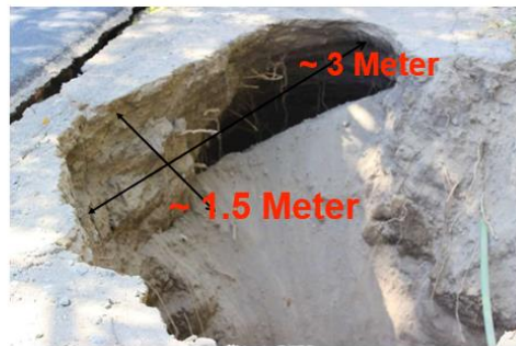
Gambar 57. Liquefaksi pada medium pasir dengan amblesan mencapai 2,5 meter dan lebar 3 m di Kecamatan Gangga, Lombok Utara
