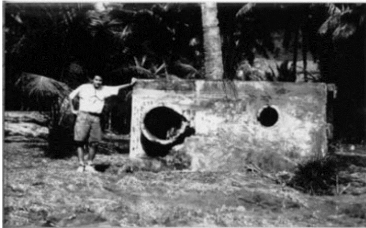
Gambar 37. Di Desa Pulo Merah terdapat balok beton saluran sanitasi warga desa yang terseret arus balik gelombang tsunami.
